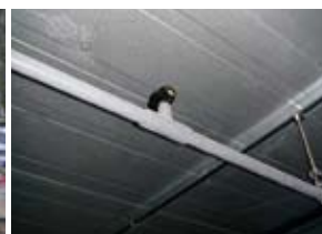
2. 舎内に設置された細霧装置
