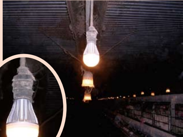
LEDランプの実際の設置例。ヒダ状の部分は放熱用の金属部分
