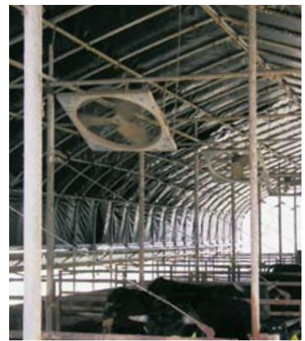
写真3：換気扇の増設・角度の調整
