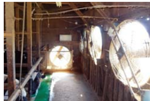
写真3.牛舎壁面に増設した排気口(トンネル換気)
