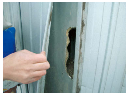
写真2.ネズミが侵入可能な外壁の穴
