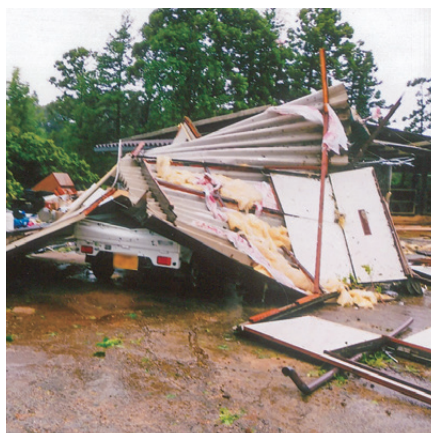
写真2. 倒壊した牛舎の下敷きになったトラック
