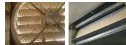
写真2 ホコリが付着した換気扇シャッター
